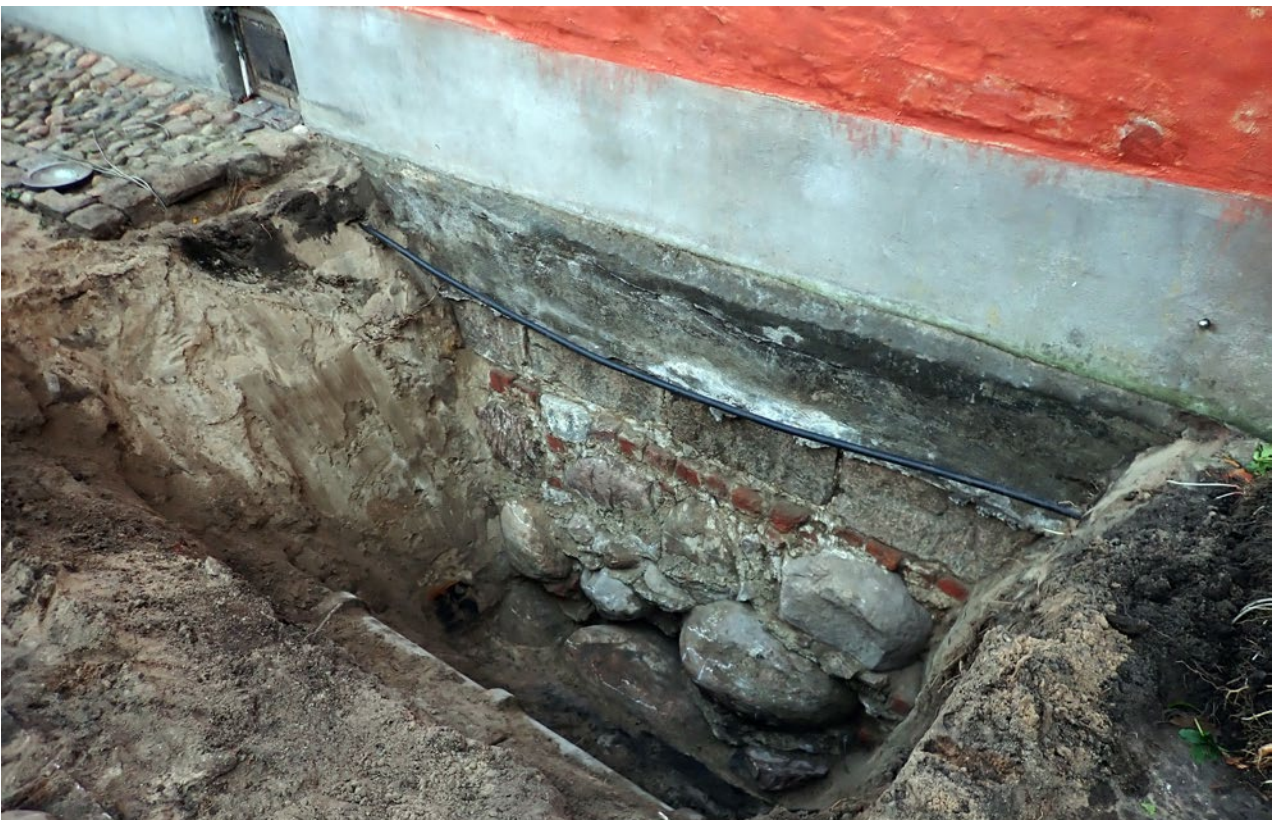
Figur 18: Intill slottsväggen syns den elledning som gick genom schakt 3000. Intill den västra schaktväggen (närmast i bild) syns även det betongrör som påträffades vid schaktningen. Mot nordost. Foto: Johan Klange. (Fotonummer 2022-92-39).
